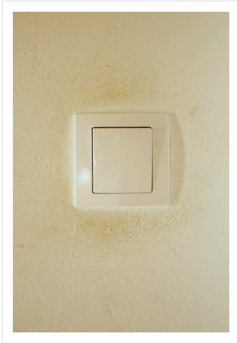
Ästhetik einer abgegriffenen Wand um einen Lichtschalter
